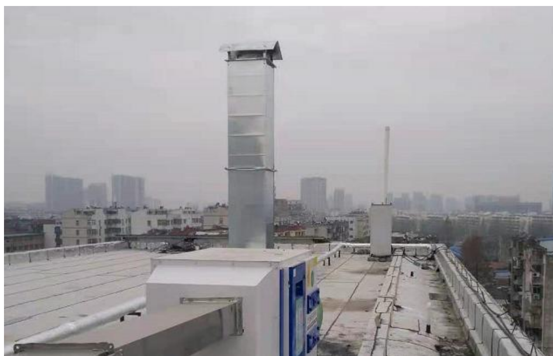
图 3-4 化实验室废气处理设备
